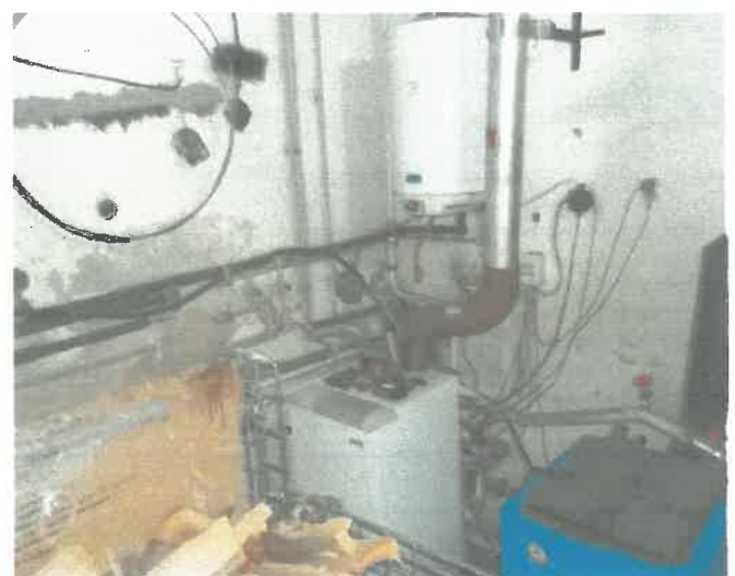
Rodinný dom s.č.6, na p.č.10, Lenartovce č.6 - I.NP kotelňa
